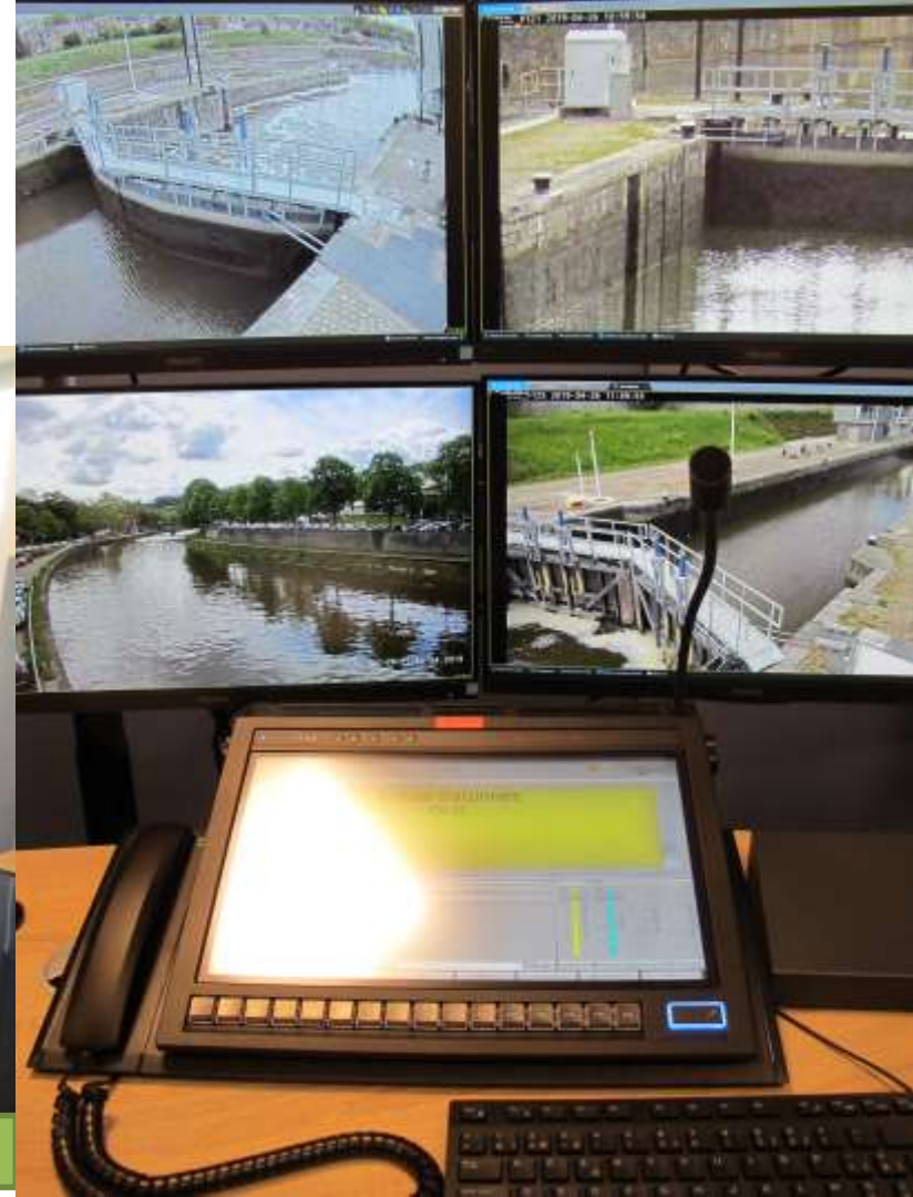
Poste de commande
